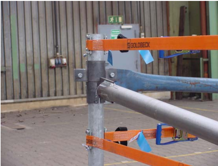
Bild 13: Eckumführung mit Diagonalanschluss mit Rohrschellenverbindung
