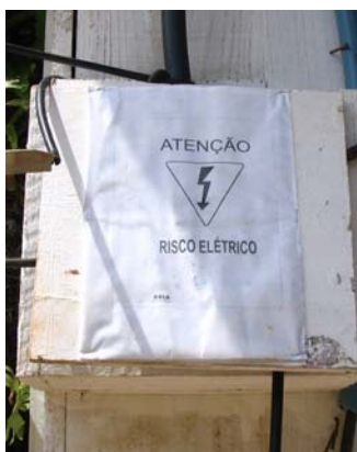
Figura 3 – Sinalização de Segurança – Risco Elétrico Fonte: Fotografia tirada em loco
