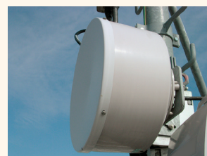
Antenne hertzienne qui permet le pilotage à distance des antennes et équipements.
