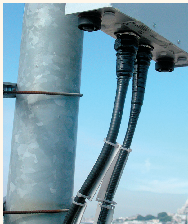
Câbles guides d'ondes.
