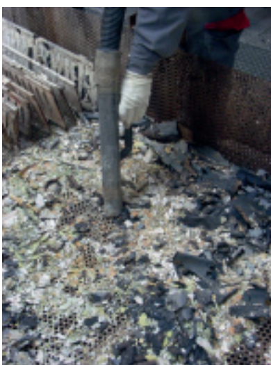
Sortie du chariot après craquelage thermique et nettoyage avec un aspirateur à filtre à très haute efficacité (THE).
