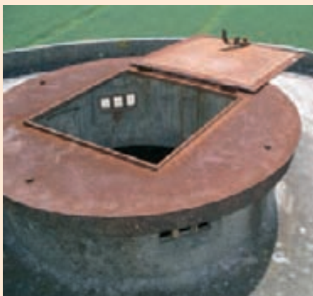
COUVERTURE SANS GARDE-CORPS, CAPOT DÉGRADÉ
